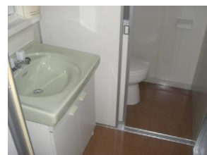
WC・洗面台
